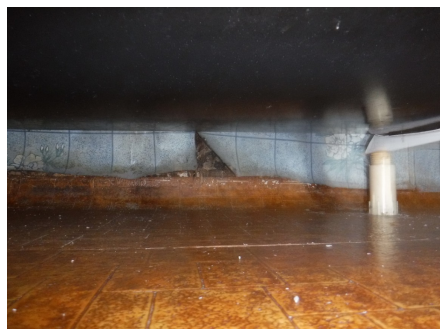
Ytterveggen bak badekarret har smuldret bort
