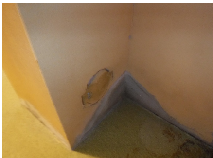
Fuktopptrekk/saltutslag på yttervegg- kan tyde på dreneringsvikt
