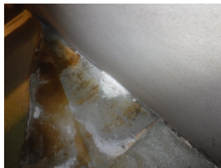
Fukt under filtbelegg ved trapp/bærevegg midt i rommet
