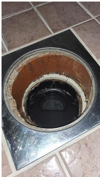
Avløpsrør (ink. sluk) - [Sluk bad]
