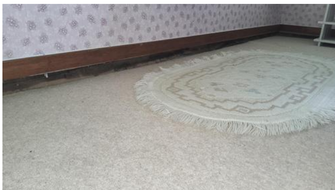
Skjevhetmåling - [Skjevheter i gulv på soverom i underetasje]
