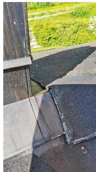
Helhetsvurdering - [Svakhet ved fotbeslag til pipe]
