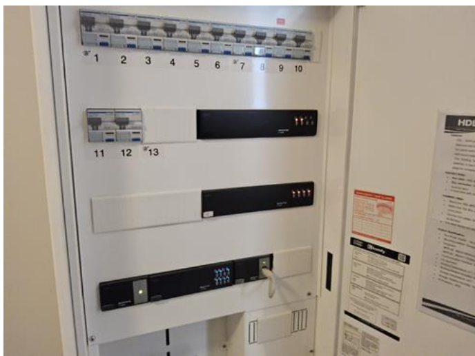
Elektrisk anlegg - [El-skap.]
