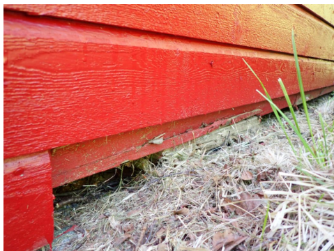
Begynnende råte i konstruksjon mot øst
