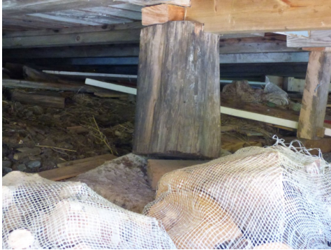
Eksempel på løs, "midlertidig" søyle
