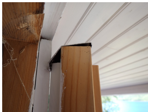
Beslag på inngangsdør vrir seg, mindre skade i karm
