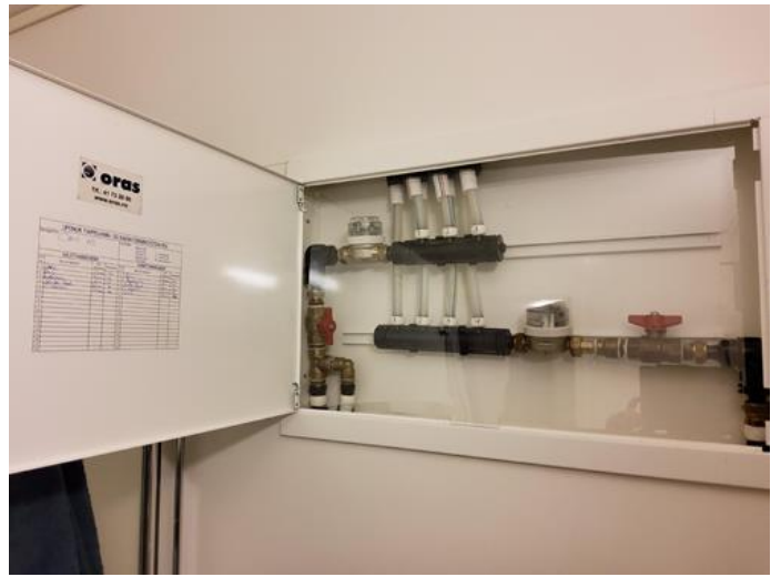
Tekniske anlegg, VVS anlegg (Sjekkpunkter utover det som er inkludert i andre rom) - [Fordelerskap bad.]
