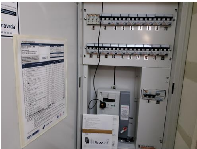
Elektrisk anlegg - [Sikringsskap ]
