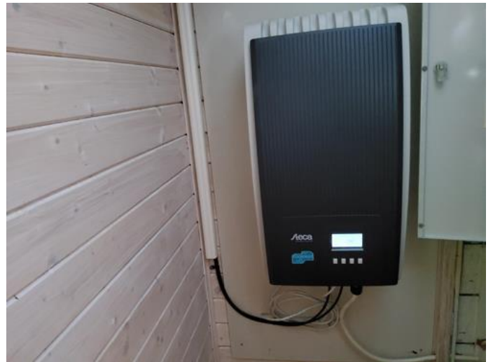
Elektrisk anlegg - [Inverter til solcelleanlegg]
