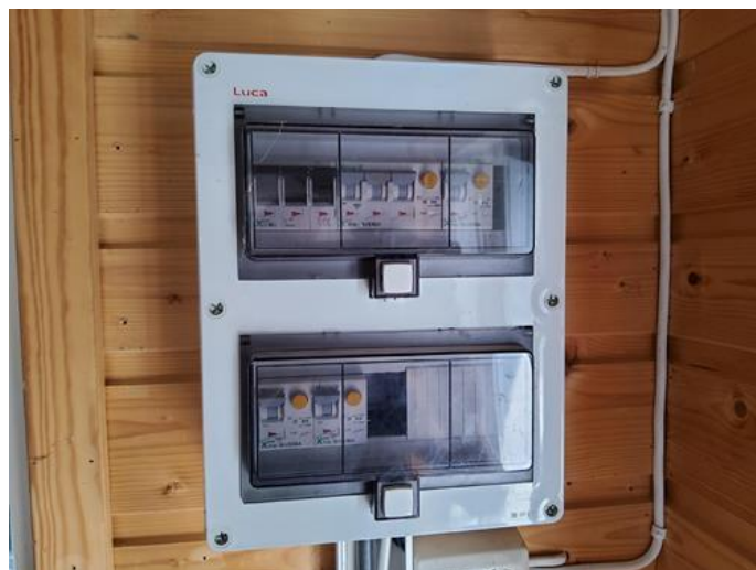
Elektrisk anlegg - [Sikringsskap i garasje.]
