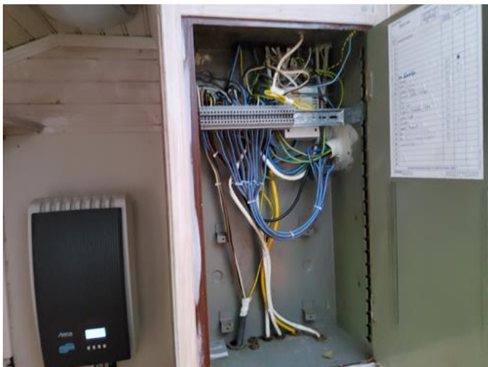
Elektrisk anlegg - [Koblingsskap ]
