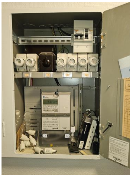
Elektrisk anlegg - [Sikringskap ]
