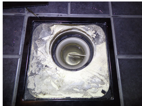
Sluk på bad/vaskerom
