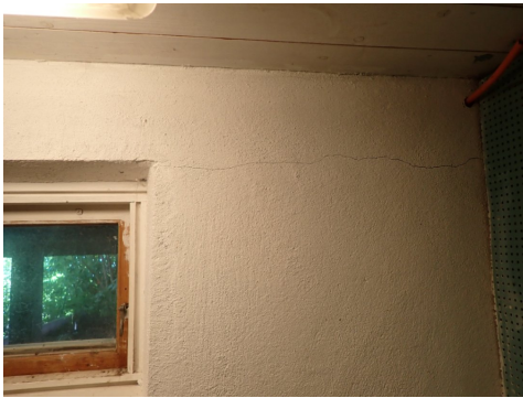
Horisontal, innvendig sprekk (bod)
