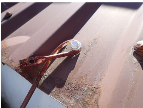
Feil innfesting av takrenne
