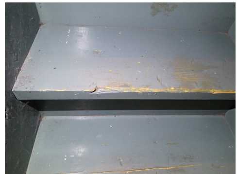
Stedvis en del slitasje/småskader i trinn
