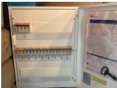
Bilde av sikringskap
