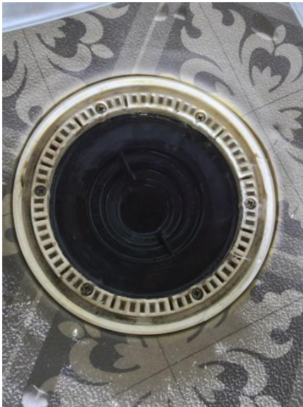
Slukets tilkomstmulighet for rengjøring - [Sluket i dusjsonen. Bad 1 etg ]
