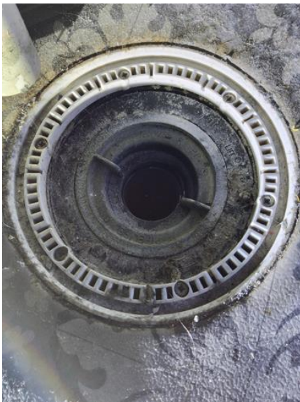
Slukets tilkomstmulighet for rengjøring - [Sluket på vaskerom ]
