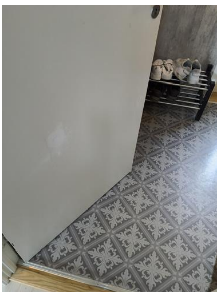
Innerdører - [Innerdør til vaskerom ]
