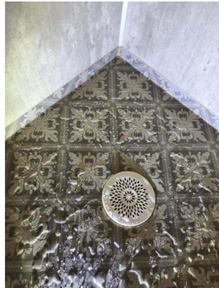
Fallforhold (gulv) - [Fallforholdet i dusjsonen. Bad 1 etg ]
