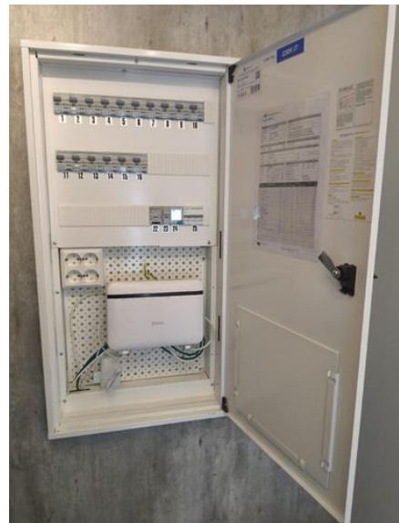
Elektrisk anlegg - [Sikringsskap ]
