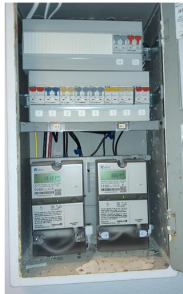
Elektrisk anlegg - [Sikringsskap]
