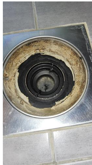
Avløpsrør (ink. sluk) - [Sluk bad leilighet]
