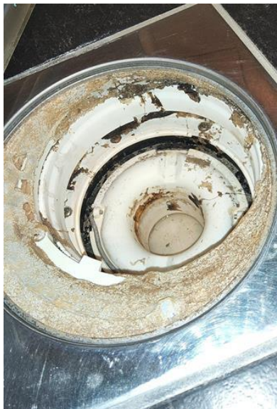
Avløpsrør (ink. sluk) - [Sluk bad 1. etasje]
