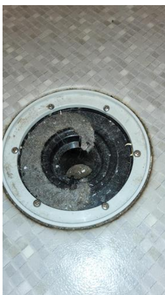
Avløpsrør (ink. sluk) - [Sluk vaskerom utenfor dusjonen]
