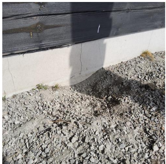
Utvendig - [Sprekker i grunnmur]
