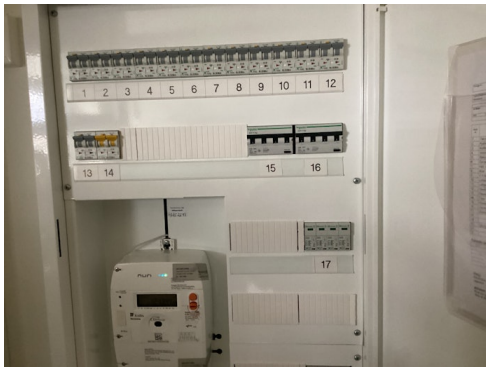
Bilde av sikringskap
