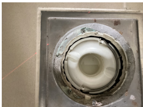
Bilde av sluk
