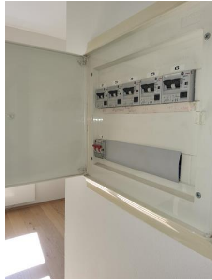
Elektrisk anlegg - [Sikringskap ]
