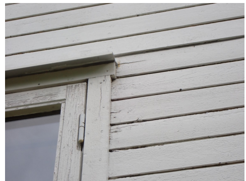
Mulig råte ved dør mot vest
