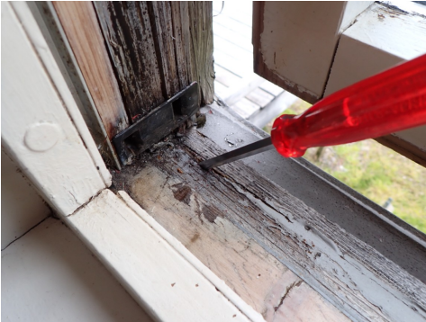
For korte pakninger, slitasje mellom karm og glassfelt
