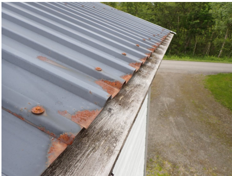
Metallplater er for korte, rust i nedkant
