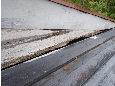
Råte i panel i overgang mot eldste del
