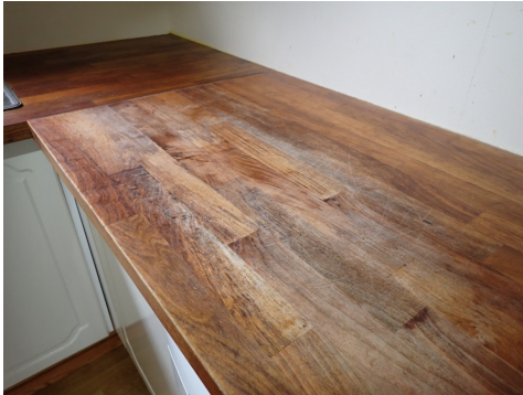
Slitasje i benkeplate
