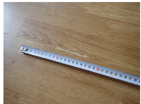
Eksempel på slitasje i laminat (stue)
