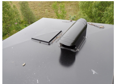
2-løps pipe, ene løpet er tettet
