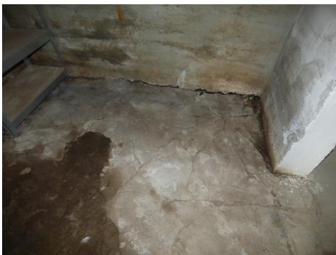
Oppsprekking av betong i rom mot vest
