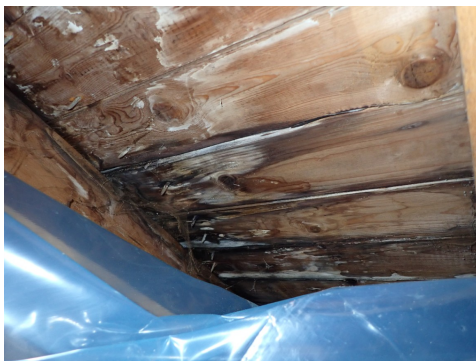
Fuktskjolder/begynnende råte i undertak.
