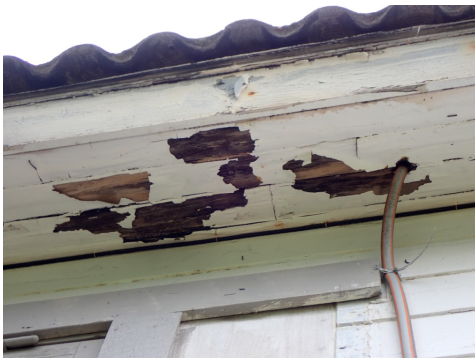
Begynnende råte i takkassen
