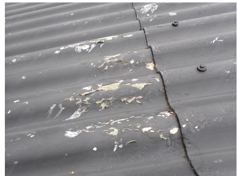
En del oppsprekking i plater
