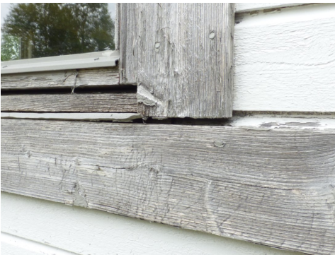
Utvendig slitasje, feil utførelse av utvendig omramming
