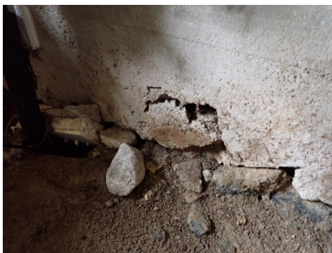
Skader i kjellerrom mot vest
