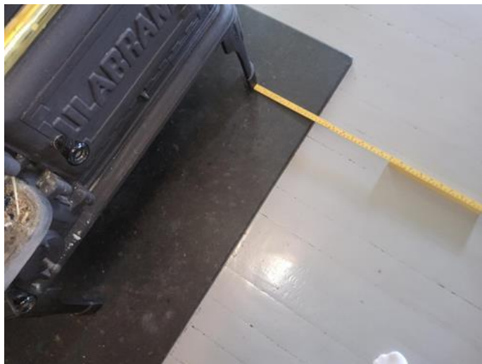
Ildsteder inne i boligen - [Liten avstand mellom ildsted og brennbart materiale i hovedhus.]
