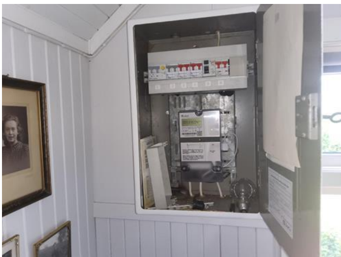
Elektrisk anlegg - [Sikringsskap. Hovedhus.]
