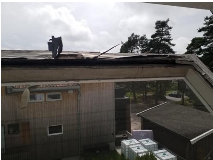
Dører og vinduer - [Råteskader på vindu i soverom 3.]
