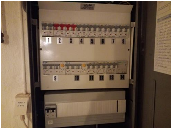
Elektrisk anlegg - [Sikringsskap i vaskekjeller.]
