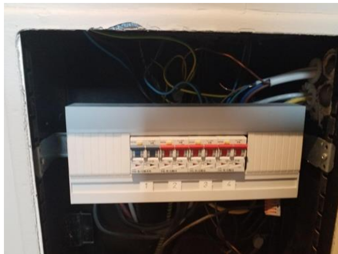
Elektrisk anlegg - [Sikkeringskap i entré/gang i 1 etasje.]
