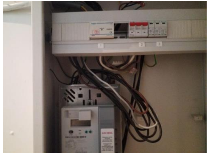
Elektrisk anlegg - [Sikringsskap i kjellertrapp.]
