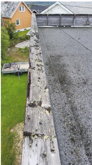
Helhetsvurdering - [Skader på vannbord]
