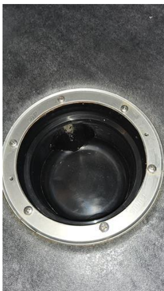
Avløpsrør (ink. sluk) - [Sluk bad 2. etasje]
