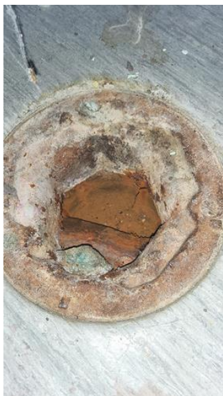
Helhetsvurdering - [Sluk bad 1. etasje]
