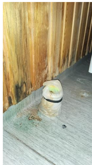
Helhetsvurdering - [Skader på vegg]
