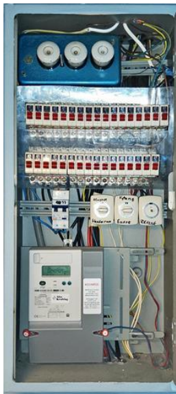
Forenklet vurdering av det elektriske anlegget - [Sikringsskap]
