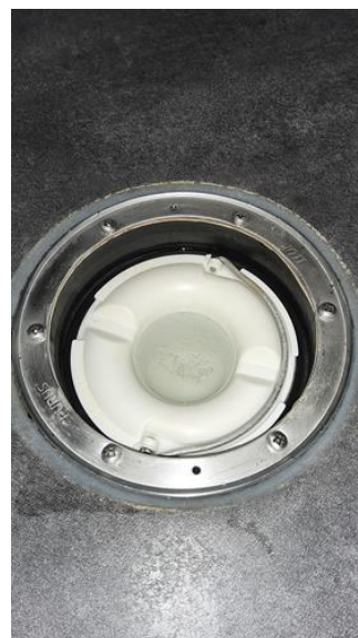
Avløpsrør (ink. sluk) - [Sluk bad 2. etasje dusj]
