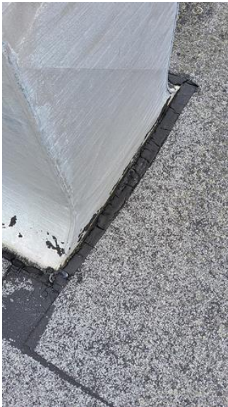
Helhetsvurdering - [Sprekker i fuge ved takhatt]
