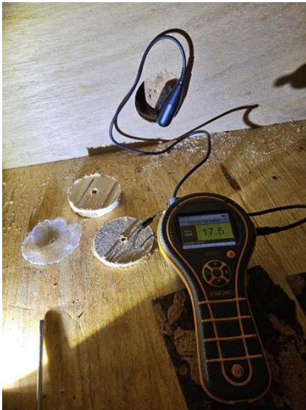
Våtrom - [Fuktmåling våtrom hytte nr. 74]
