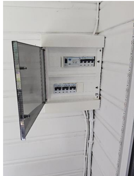
Elektrisk anlegg - [Sikringsskap hytte nr. 74.]
