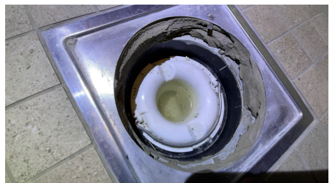
Sluk i gulv.
