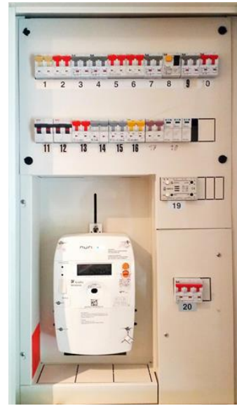
Forenklet vurdering av det elektriske anlegget - [Sikringssskap]
