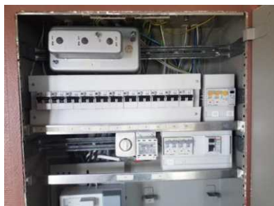
Elektrisk anlegg - [Sikringsskap.]
