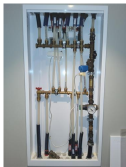
Vannrør - Fordelerskap (gang kjeller).
