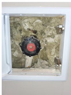
Vannrør - Hovedstoppekran (gang kjeller).
