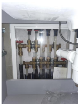
Vannrør - Fordelerskap (i servantskap).
