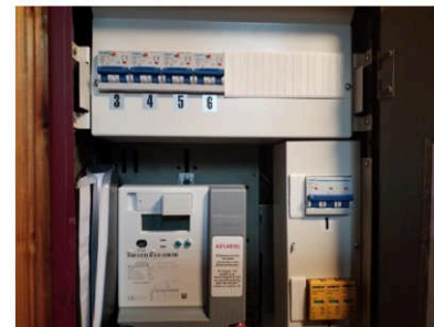
Elektrisk anlegg - [Sikringsskap. ]
