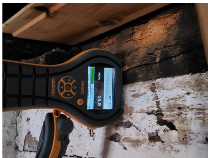
Kommentar - [Fuktmåling i drage med råteskader. ]
