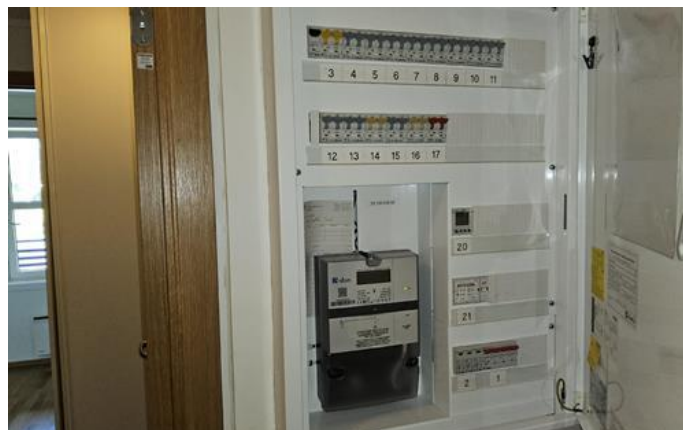
Elektrisk anlegg - [Sikringsskap.]
