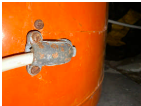
Rust på varmtvannsbereder.
