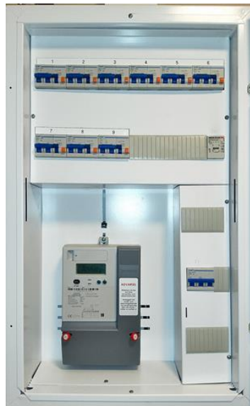
Forenklet vurdering av det elektriske anlegget - [Sikringskap]
