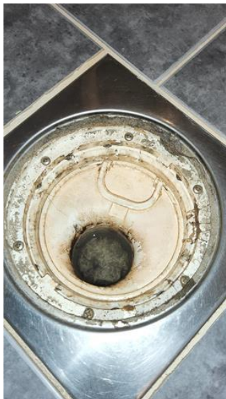
Avløpsrør (ink. sluk) - [Sluk bad]
