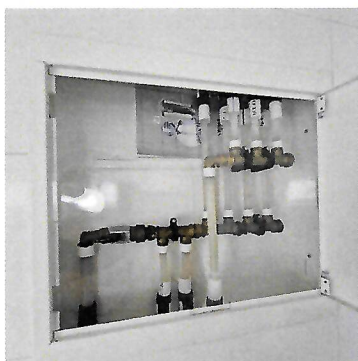
Rørskap til leil i underetasje.
