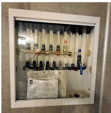
Rørskap for hovedetasje m.m.
