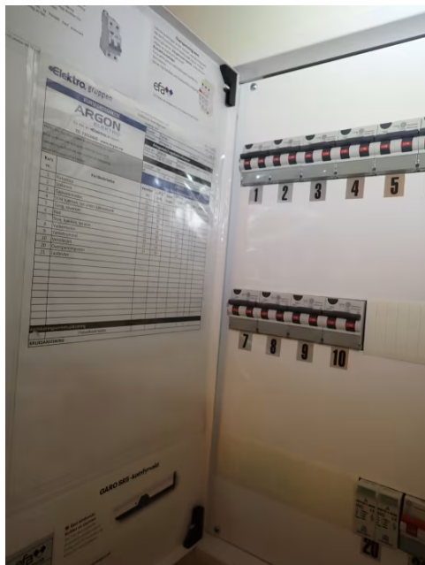
Sikringsskap er plassert på bod.
