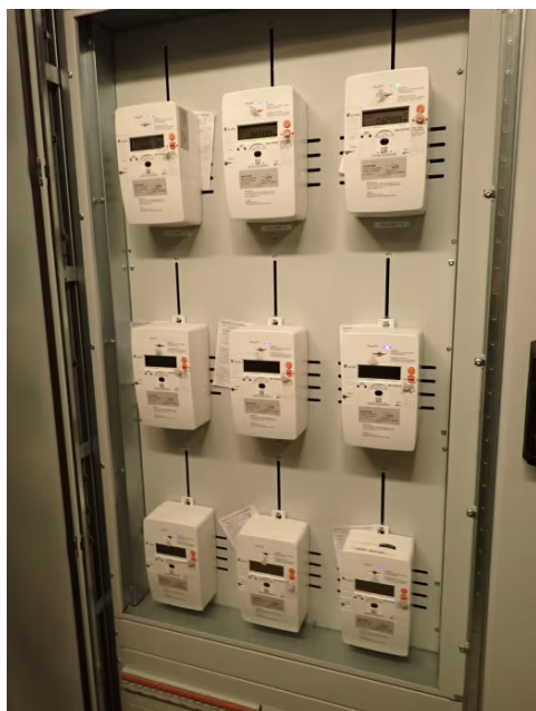
Måler er plassert i felles skap i teknisk rom i kjeller.
