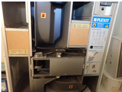
Ventilasjonsaggregat er plassert på bod i leiligheten.
