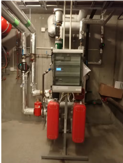
Felles anlegg for vannbåren varme/fjernvarme i kjeller.
