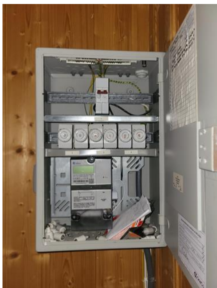
Elektrisk anlegg - [Sikringskap]
