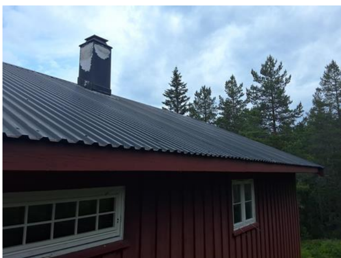
Utvendig - [Yttertak, slitasje på pipebeslag]
