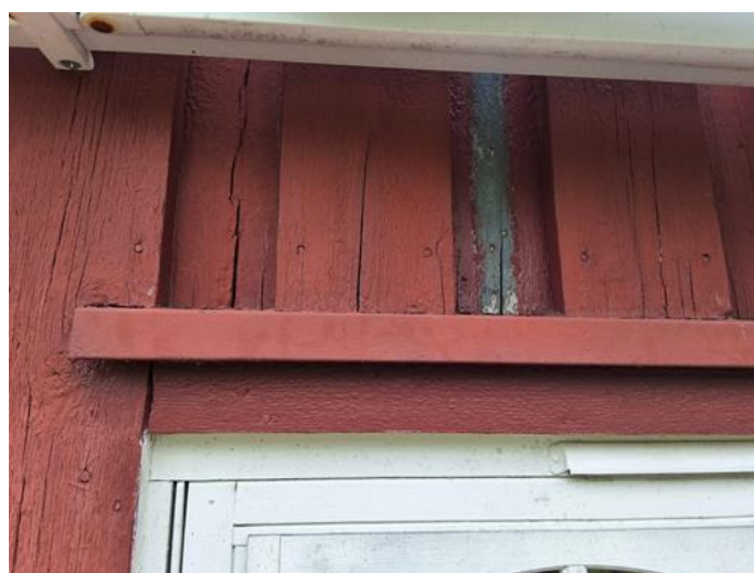
Yttervegger inkl. fasader og konstruksjon - [Oppsprekk kledning]
