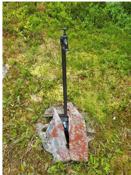
Utvendig - [Vannpost ved borehullet]
