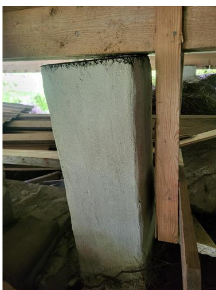
Utvendig - [Løst fundament ]
