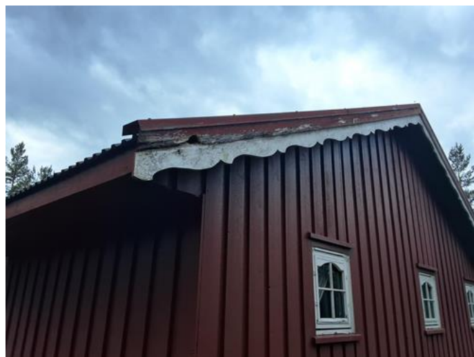
Utvendig - [Yttertak, slitasje på vindskier]
