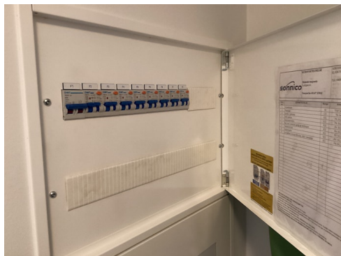
Bilde av sikringskap
