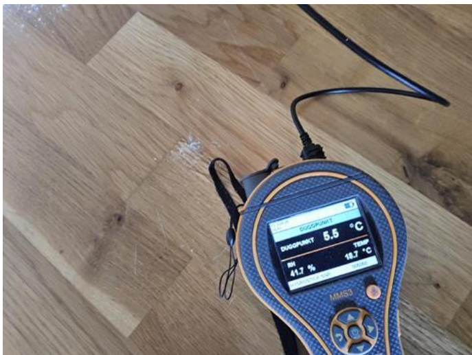
Fukt i tilliggende konstruksjoner - [Fuktmåling bad 1. etasje.]
