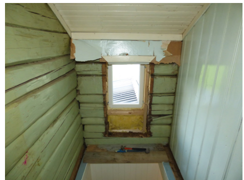
Eksempel på manglende arbeider ifm vindu
