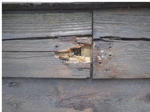
Råte i kledning mot vest.
