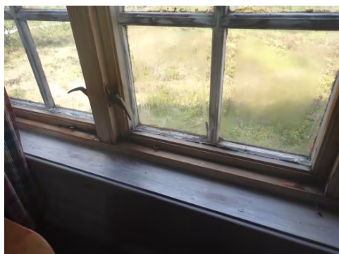
Lekkasje i vindu.
