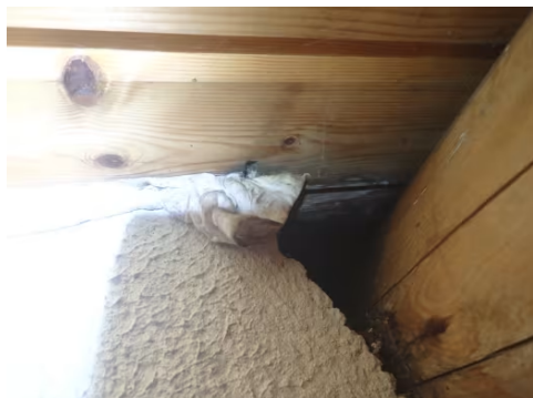
Fuktmerker/mindre skade i innvendig tak ved pipe.
