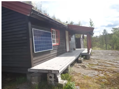
Manglende rekkverk på terrasse.
