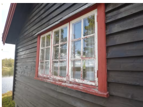
Utvendig slitasje og manglende beslag.
