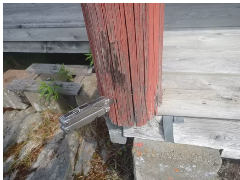
Råte i stolper til takoverbygg.
