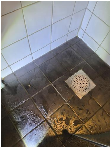
Fallforhold (gulv) - [Fallforholdet i dusjsonen. Bad 1 etg ]
