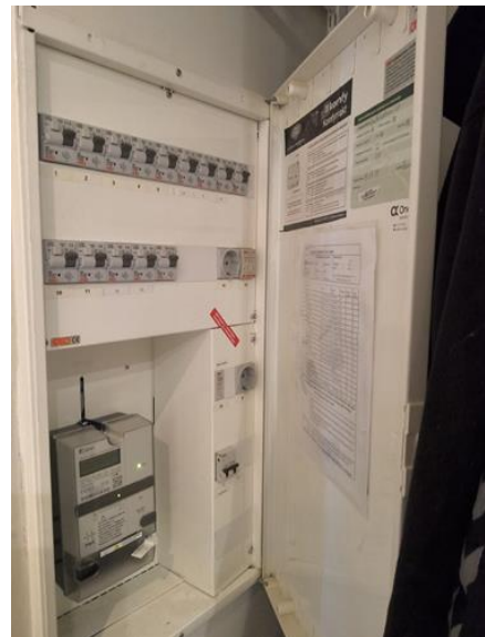
Elektrisk anlegg - [Sikringsskap ]
