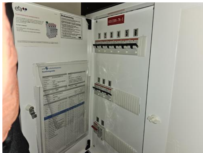
Elektrisk anlegg - [Sikringskap. ]
