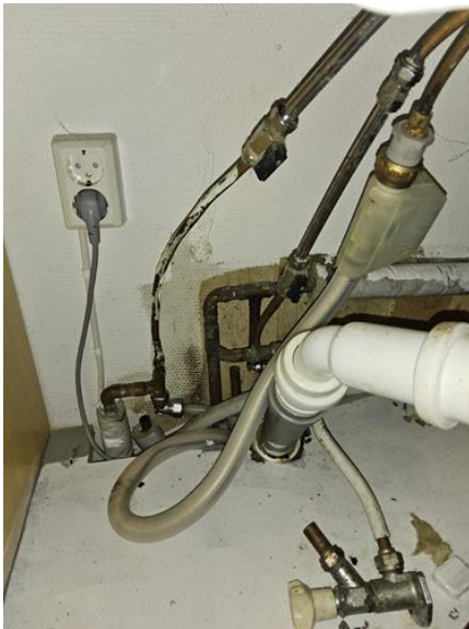
Vannrør - [Vannrør av kobber ]
