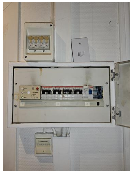
Elektrisk anlegg - [Sikringsskap]
