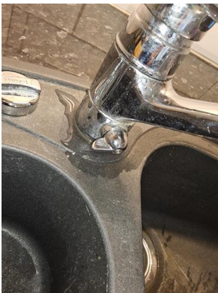
Annet - [Lekkasje fra blandedbatteriet]
