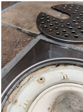
Sluk og klemring. Rester av smøremembran synlig over klemring.
