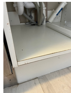
Fuktmerker i benkeskap under vask.
