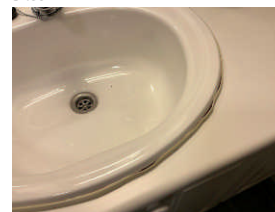
Løs pakning rundt vask.
