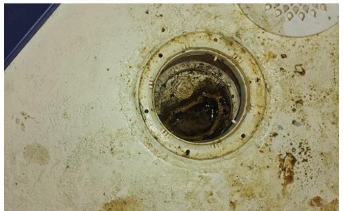
Avløpsrør. (Sjekkpunkter utover det som er inkludert i andre rom) - [Sluk på teknisk rom.]
