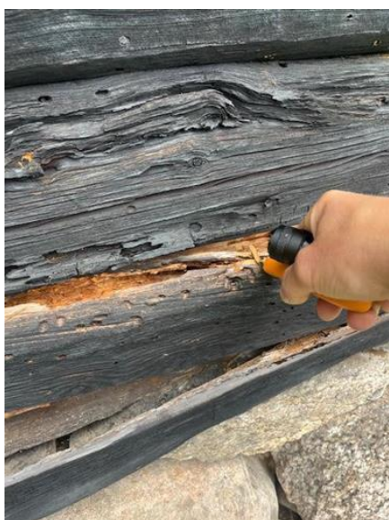
Utvendig - [Treskadeinsekter/råteskader på aneks og frittstående byggverk. ]
