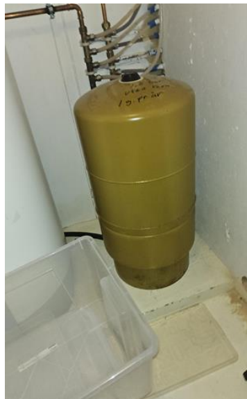
Vannrør (Sjekkpunkter utover det som er inkludert i andre rom) - [Trykktank.]
