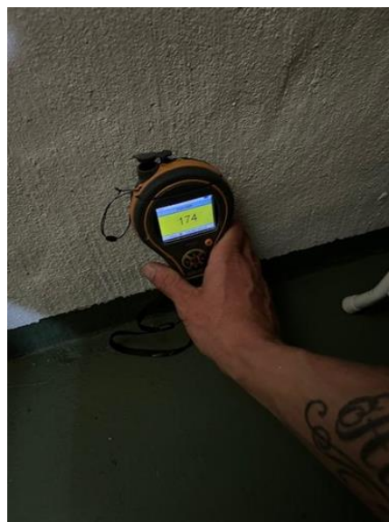
Utvendig - [Forhøyede fuktverdier i underetasjen. ]
