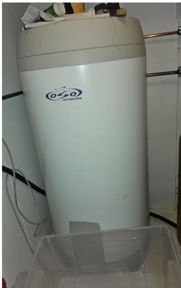
Varmtvannsbereder (Sjekkpunkter utover det som er inkludert i andre rom) - [ Varmtvannsbereder. ]
