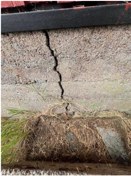
Utvendig - [Sprekk i grunnmur.]
