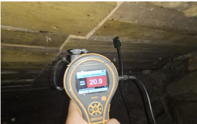
Innvendig inspeksjon - [Forhøyet fuktverdi i himling krypekjeller.]
