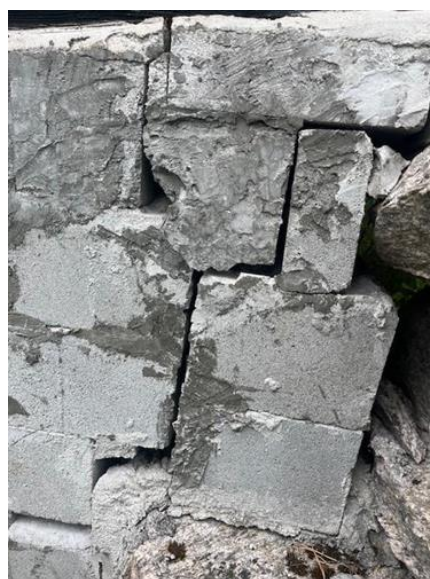
Utvendig - [Sprekk i grunnmur til aneks.]
