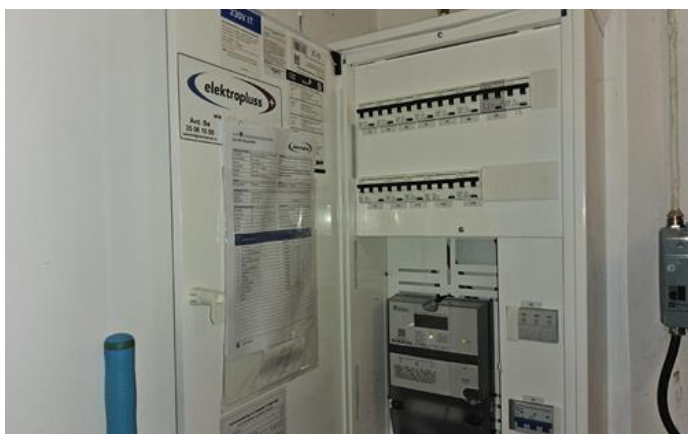
Elektrisk anlegg - [Sikringskap. ]
