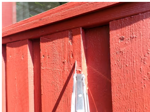
Råte i stående kledningsbord mot vest.
