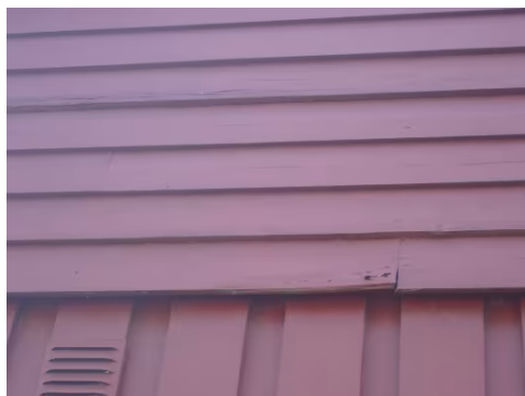
Råte i gavl mot nord.
