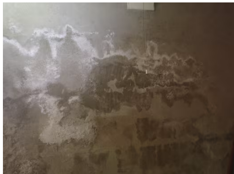
Salt/kalkutslag på vegg i bod 1.
