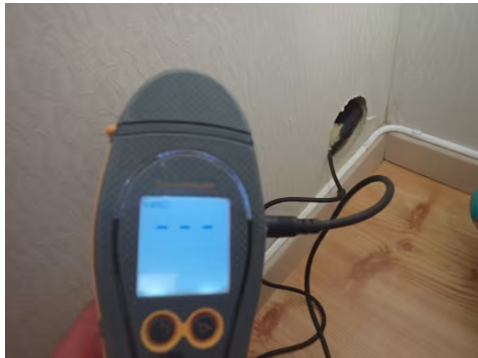
Fuktmåling fra tilliggende soverom.
