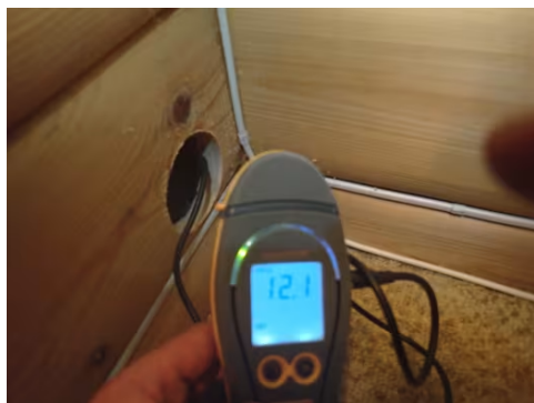
Fuktmåling i vegg på kjellerstue.
