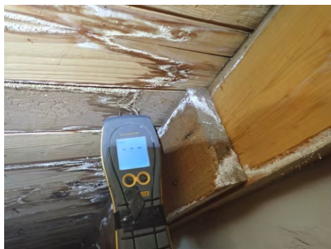
Eldre fuktmerker i undertak på kaldtloft.
