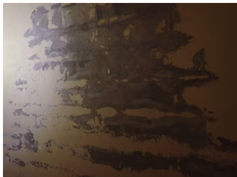
Malingsavskalling og kondens på murvegg i kjølerom.
