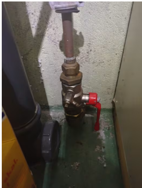
Stoppekrane i bod 1.
