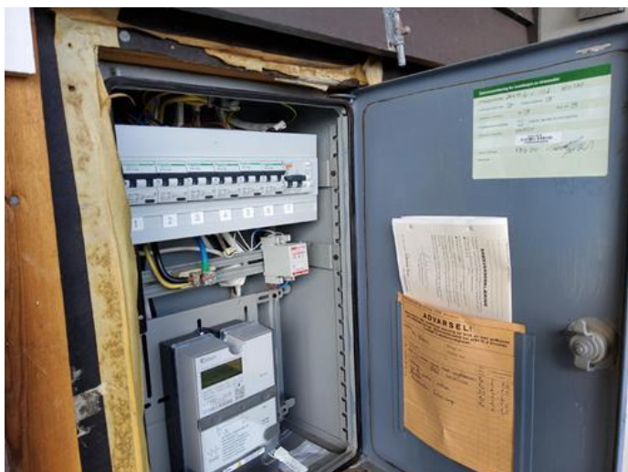
Kommentar - [Sikringsskap plassert i felles gang.]
