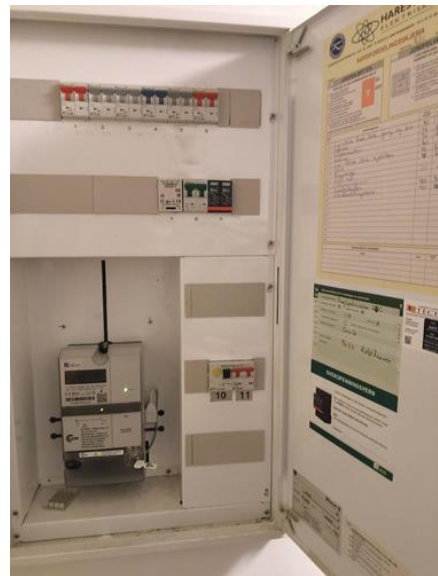
Elektrisk anlegg - [Sikringsskap]
