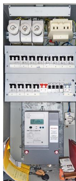
Forenklet vurdering av det elektriske anlegget - [Sikringskap]
