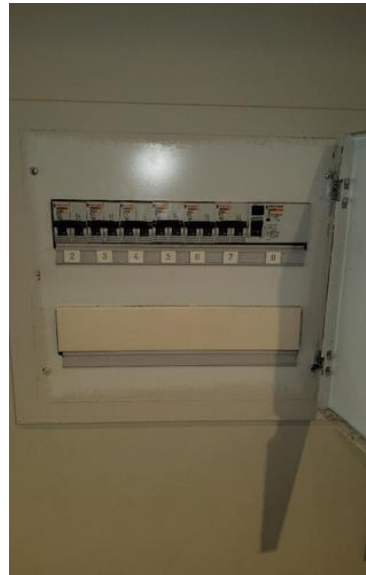
Elektrisk anlegg - [Sikringskap ]
