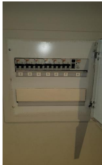
Elektrisk anlegg - [Sikringsskap]
